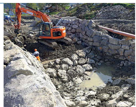
Bild 10. Kolkwanne, Prinzip und Bauausführung, Fließrichtung im Foto von rechts nach links.
